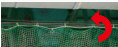
防鳥ネットと屋根との間に隙間あり!
